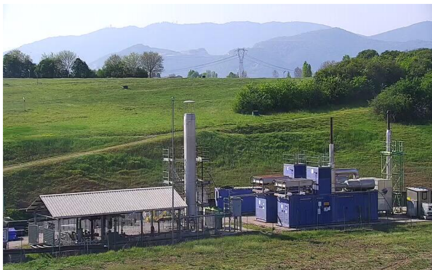
Figura 16 - Veduta dell'impianto di aspirazione del biogas
