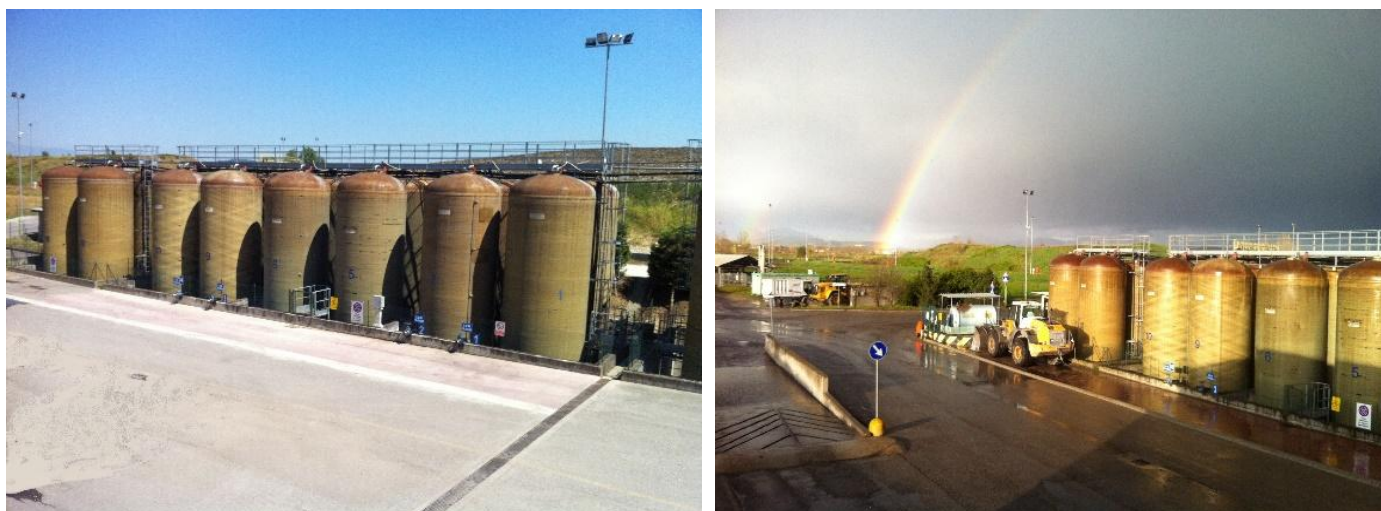
Figura 14 - Serbatoi di raccolta del percolato
