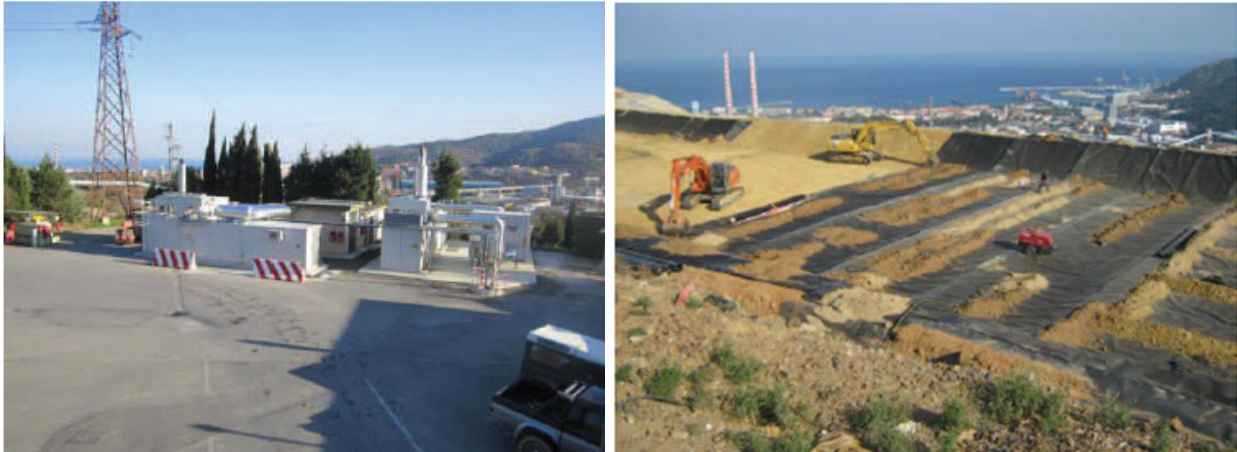
Figura 1 – Discarica e impianto di produzione di energia elettrica
