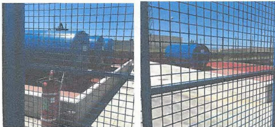
Foto parco serbatoi
